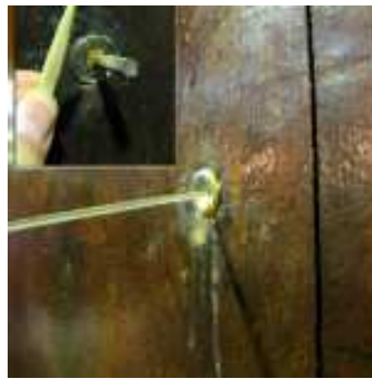
Das Austrittsloch mit dem Eichenstopfen
